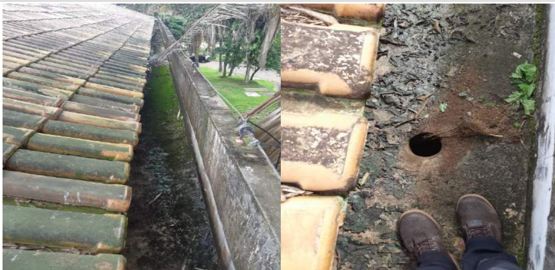
Figura 28: Calha e tubo de queda antes da limpeza.
