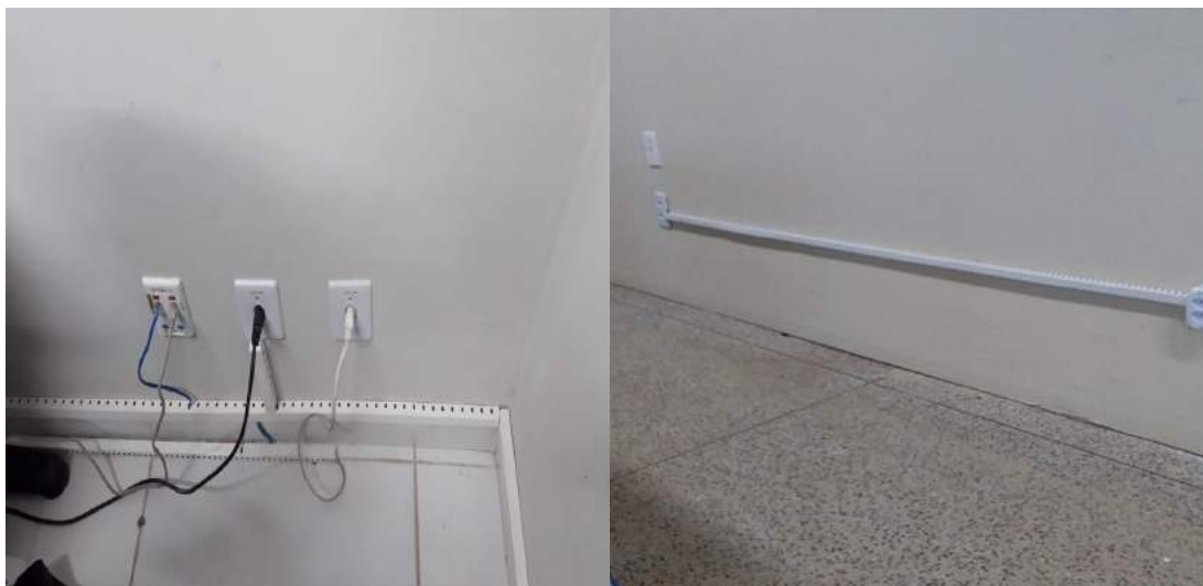
Figura 30: Fiação de ambientes didáticos e administrativos por dentro de canaletas instaladas
