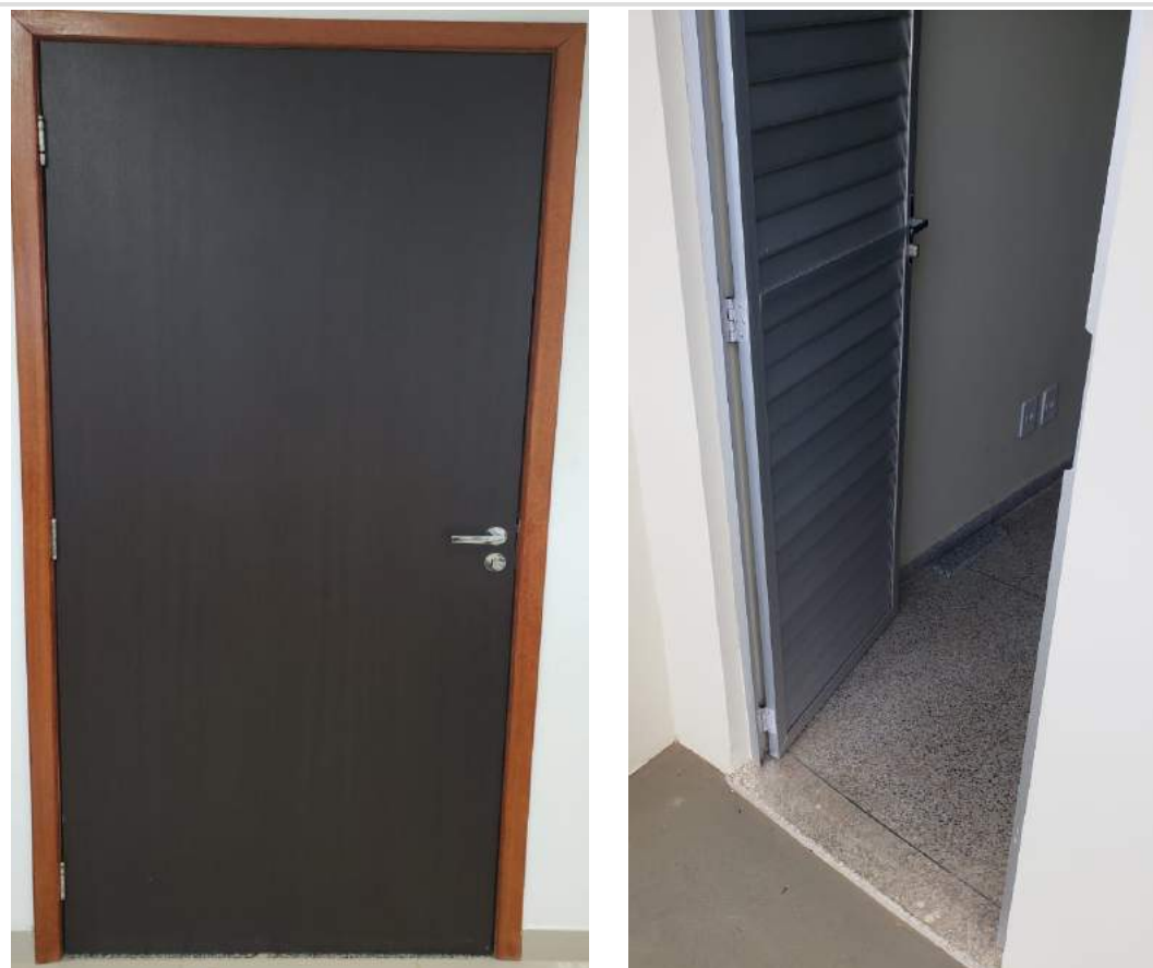
Figura 12: Portas laminadas e em alumínio nos setores administrativos e salas de aula
