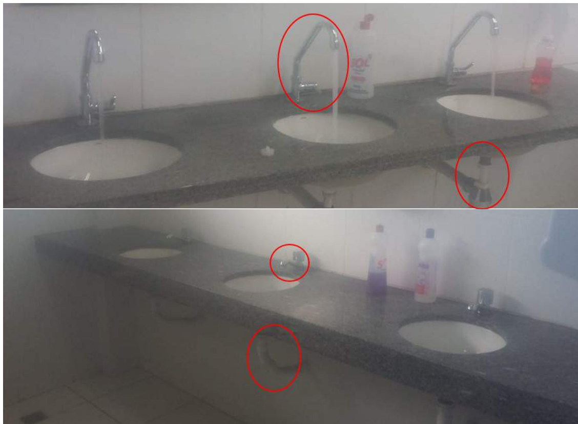
Figura 20: Bancada das Instalações Sanitárias – Diferença de torneiras e sifão
