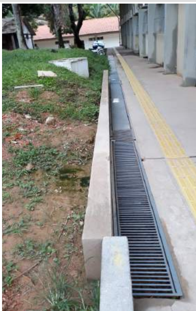
Figura 39: Canaleta para escoamento de água pluvial.
