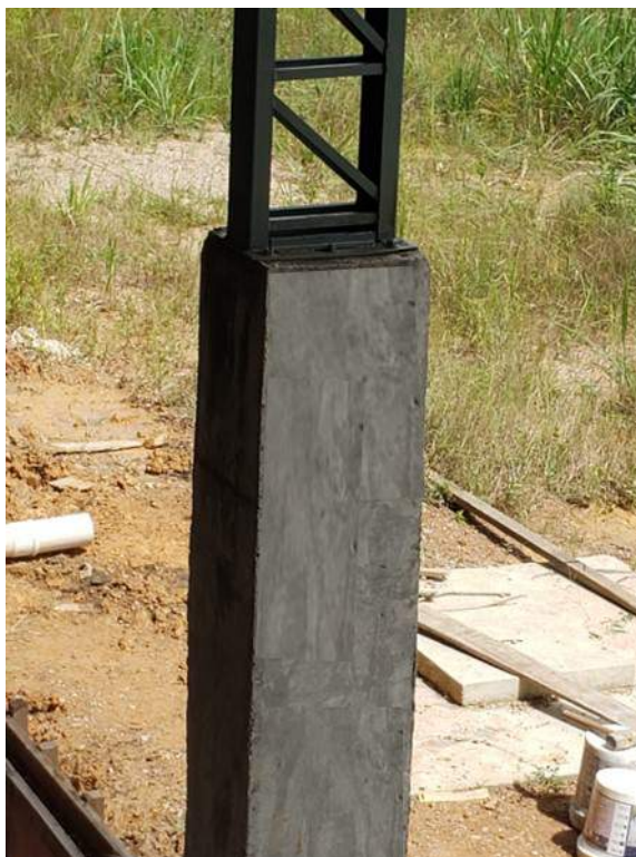
Figura 5: Estrutura em concreto aparente do estacionamento em bom estado de conservação – Unidade III/Campus Marabá
