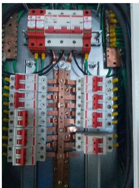
Figura 32: Quadro elétrico novo
