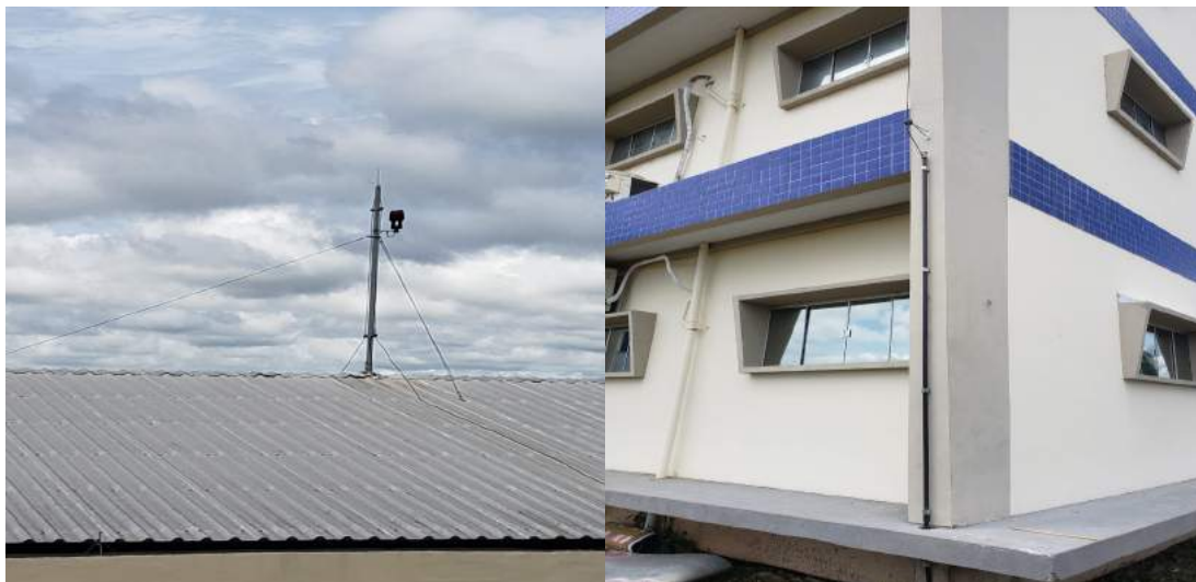
Figura 36: Para Raio – Cobertura da Edificação – Terminais aéreos - ponta de Franklin e aterramento
