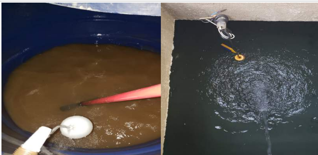
Figura 27: Limpeza de caixa d'água e teste do automático de bóia.
