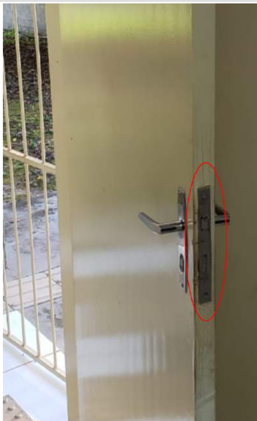
Figura 13: Fechadura danificada com necessidade de reparo
