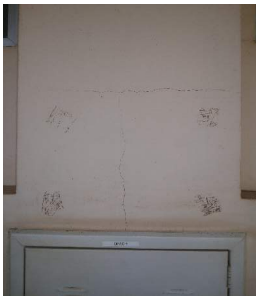
Figura 3: Exemplos de paredes internas com trincas
