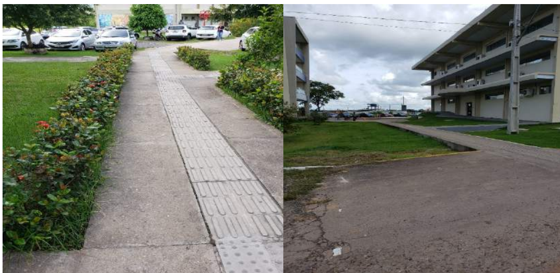
Figura 38: Calçadas com piso tátil e rampa do piso desgastado
