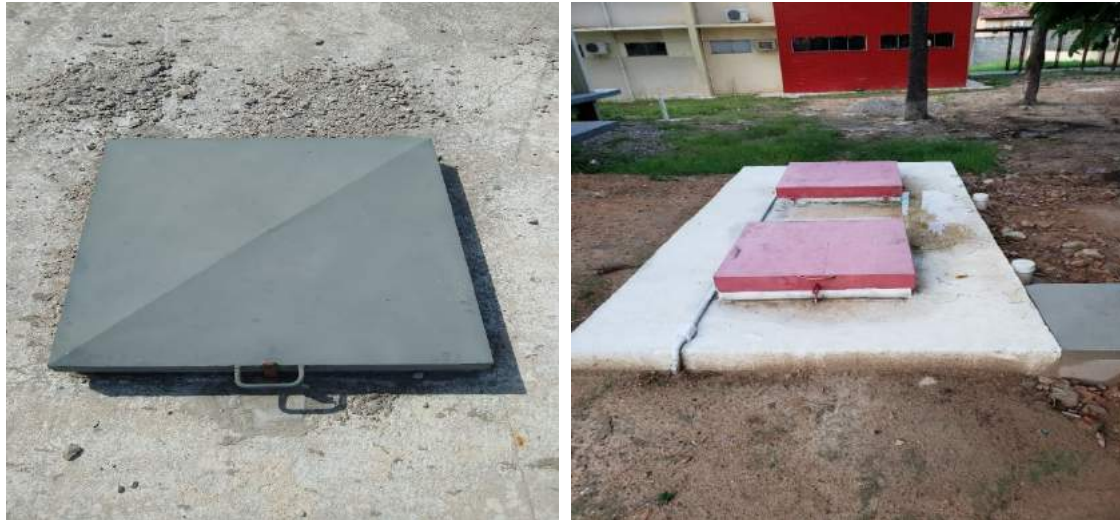
Figura 25: Cisterna padrão em bom estado de conservação e tampa de reservatório superior com necessidade de substituição.
