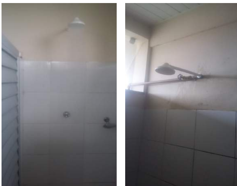
Figura 21: Chuveiros com instalação e válvula diferente.
