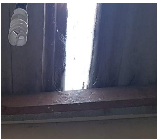
Figura 9: Telhas de Fibrocimento danificadas que necessitaram de manutenção
